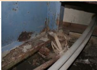
部分的な腐食（板厚欠損）
