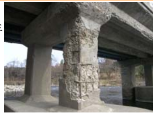
鉄筋腐食による耐荷性の低下
