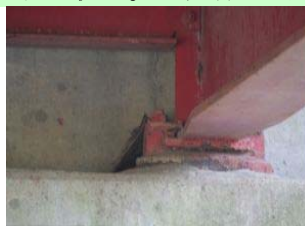
桁端部の腐食
