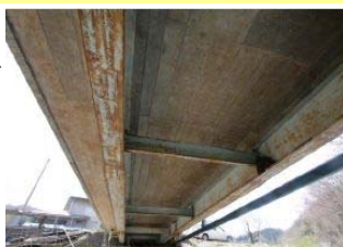
広範囲の腐食
