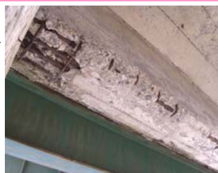
鉄筋腐食による耐荷性の低下
