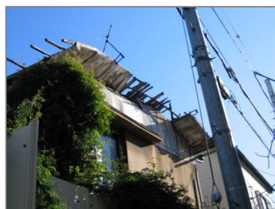
図 26：屋根が破損している例
