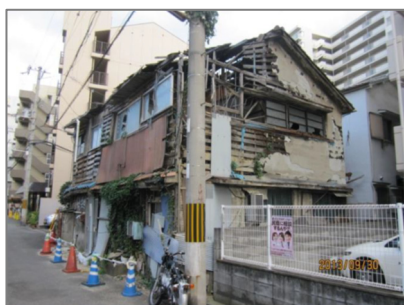
図 25：壁が脱落している例
