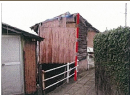
図 21：一部の柱が傾斜している例
