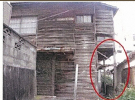
図 22：柱の数箇所に破損がある例
