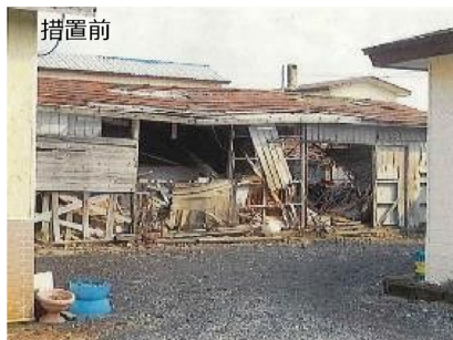
図 27：開口部が破損している例
