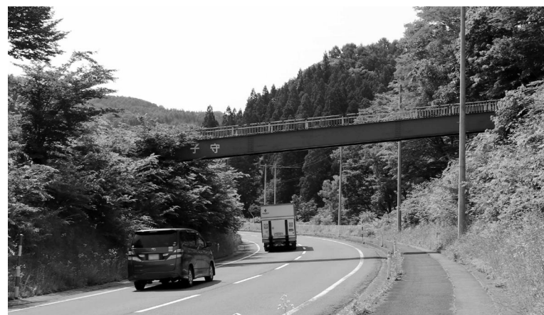
経年劣化が進んでいる子守歩道橋
