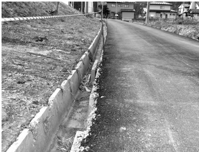
側溝の改修が待たれる町道馬場平支線
