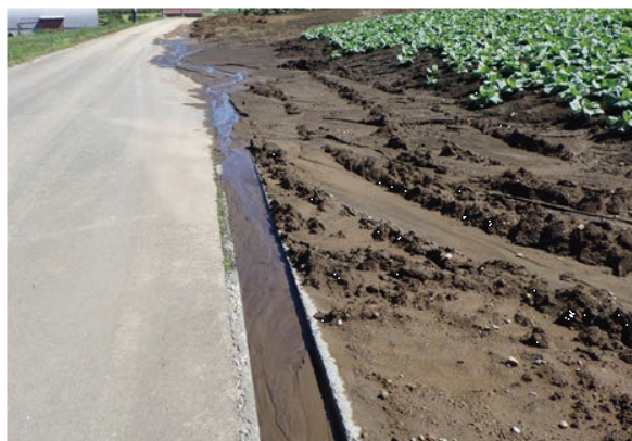
【側溝泥上げや土砂撤去が必要な事例】
