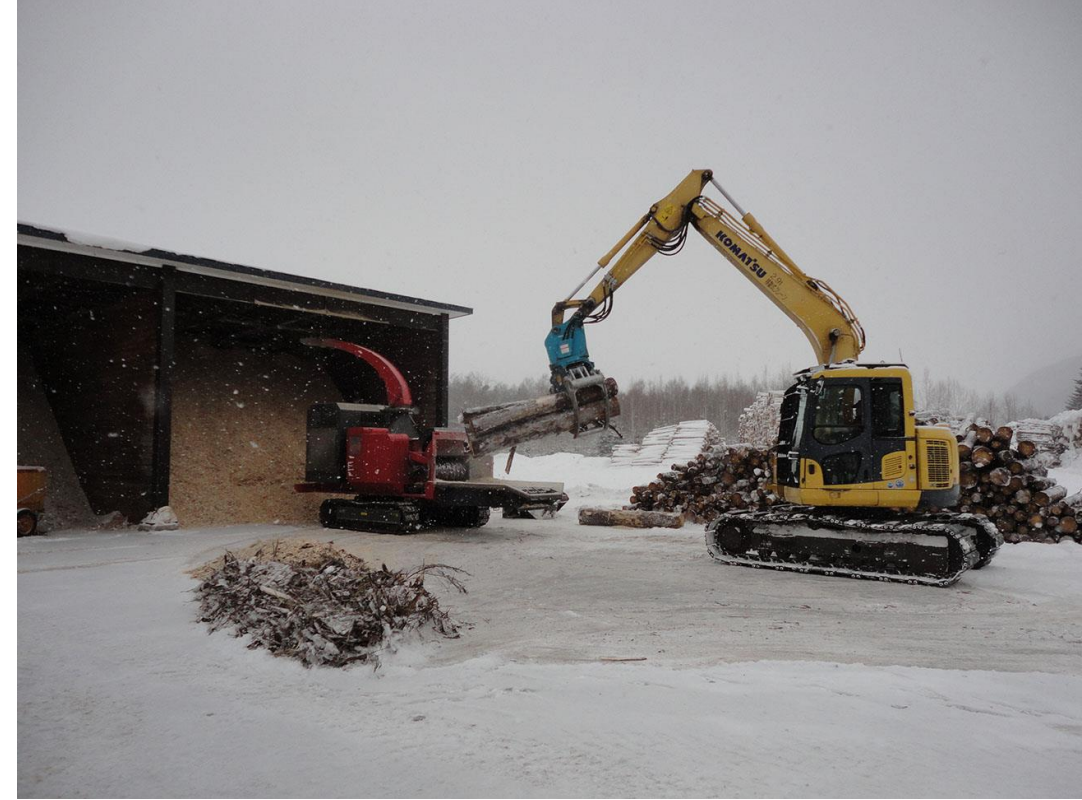
上川町のチップ製造施設
